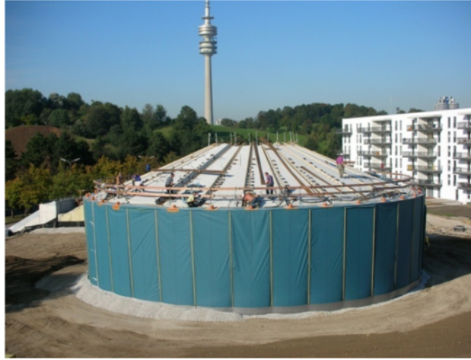
FIGURE 1.27 – TTES installé à Munich[40].
